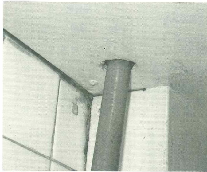
▲写真1 パイプ周辺の隙間 (工事前)
