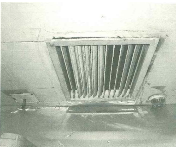
▲写真5 空調ダクト吹き出し口の隙間 (工事前)
