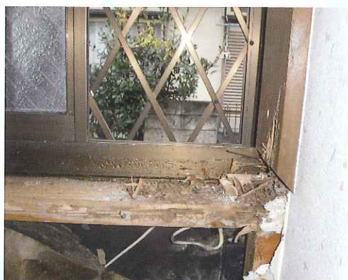
写真2 洗面所窓台と柱の被害(2)
