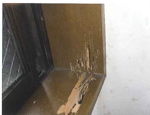
写真1 洗面所窓台と柱の被害(1)
