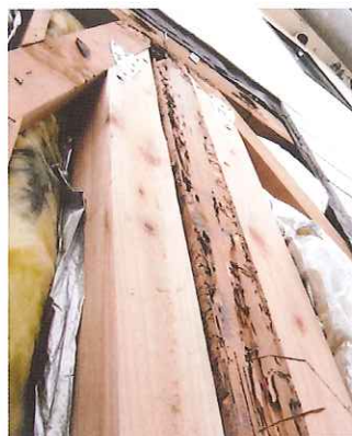
写真6 両側を添え木された浴室
