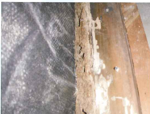
写真4 洗面所柱の被害
