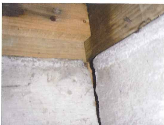
写真3 基礎コンクリートの角の亀裂
