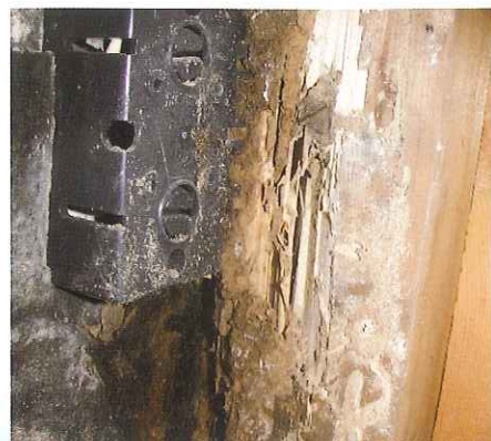
写真5 洗面所柱に運び込まれた土
