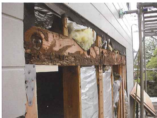
写真7 1階天井の胴差しの被害
