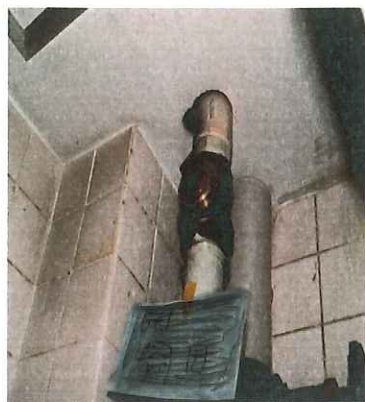
写真 17 パイプ周囲の隙間
