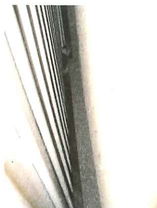
写真5 出入口シャッターの上部隙間
