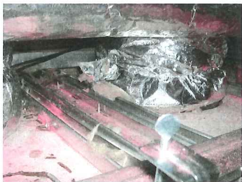
写真 18 給湯器の排気ダクト周囲の隙間（天井部分）
