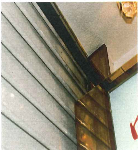
写真 20 シャッター上部の隙間
