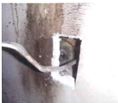
▲写真5 蔵庫裏の電気コード周囲の隙間
