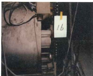
▲写真2 シャッタースラット収納ケースのローラチェーン周囲の隙間
