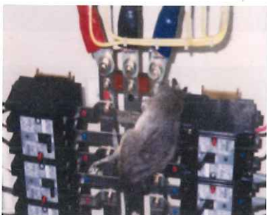
▲写真3 配電盤内部におけるネズミによる短絡事故
